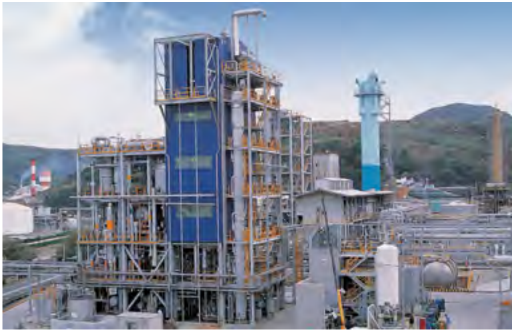
희황산 농축처리시설 (전남 여천) 완공일 : 2000.04
